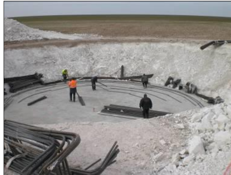
Photo 67 : Exemple de fondations à remettre en état
