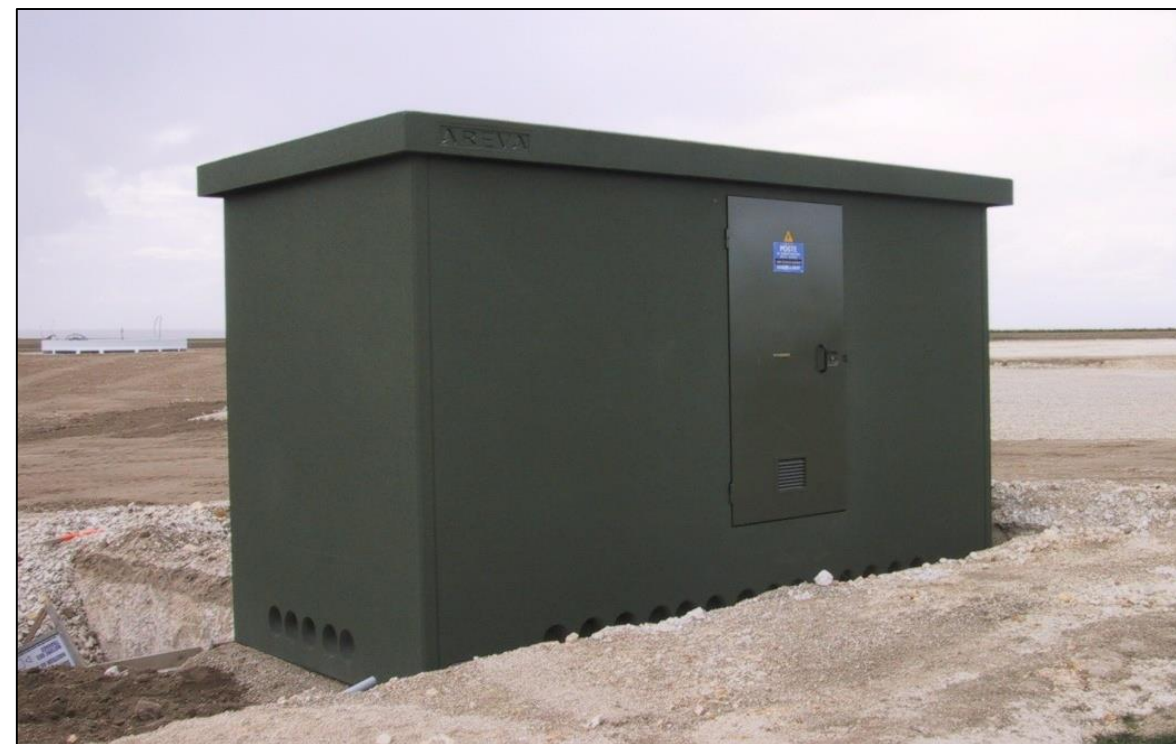
Photo 162 : Photo de référence d'un poste de livraison (Source : BE JC)
